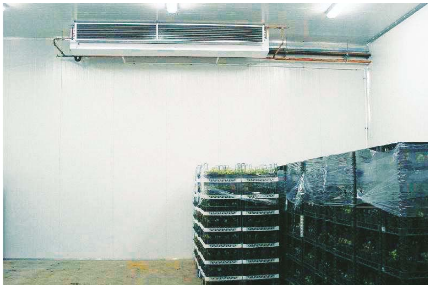
Met de koelinstallatie waarbij er voor de koeler een voorziening is aangebracht voor verwarming kan de RV in de bewaarcel worden verlaagd.
