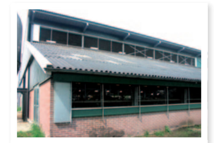
↑ DE NIEUWE EN OUDE STAL VORMEN NU ÉÉN GEBOUW. WAAR VROEGER DE NOK ZAT IS NU DE GROTE LUCHT- EN LICHTINLAAT VAN HET EERSTE DAK.
