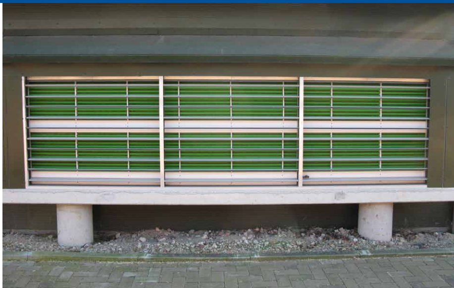
Warmtewisselaar aan de buirenkant van de stal.
