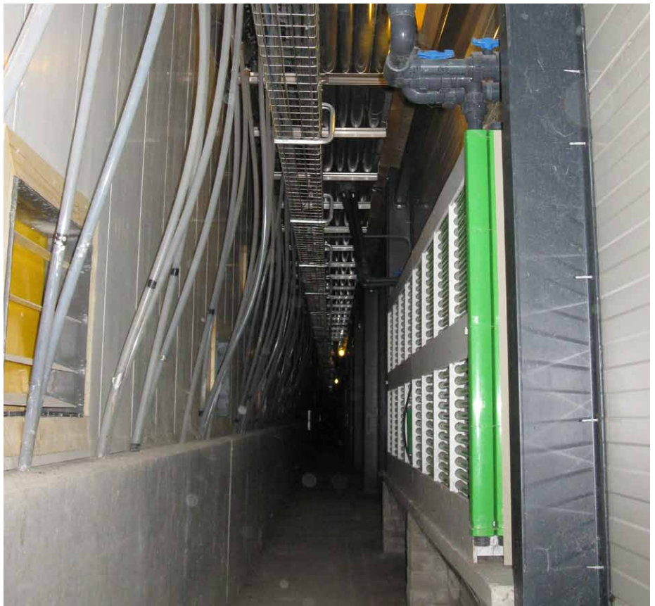
Een luchtinlaat gang. Rechts de 'groene buisjes' van de warmtewisselaars, links de voedingslangen van de vloerverwarming.
