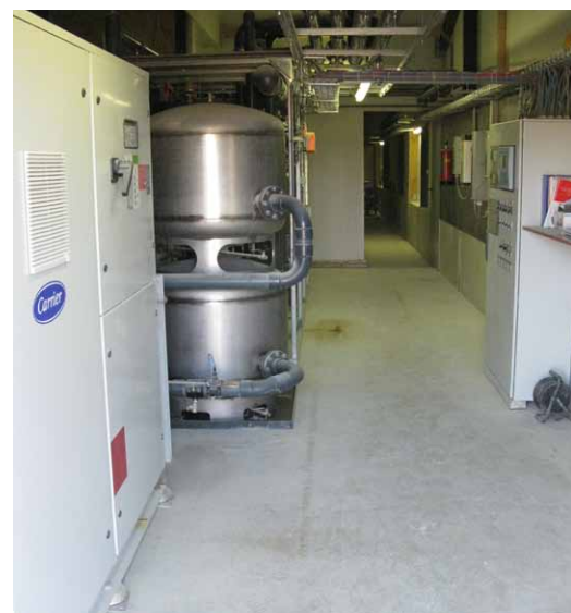
De warmtepomp met een tank voor opslag van warm en koud water.
