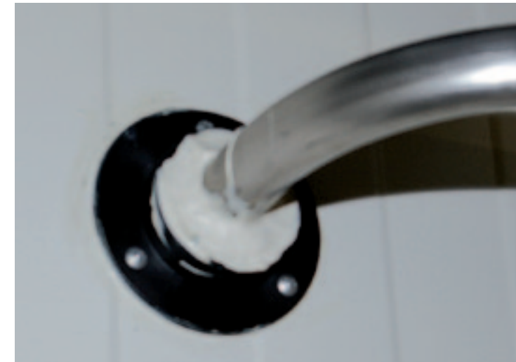
▲ Bij ammoniakkoeling moeten alle leidingen in roestvrijstaal worden uitgevoerd.
