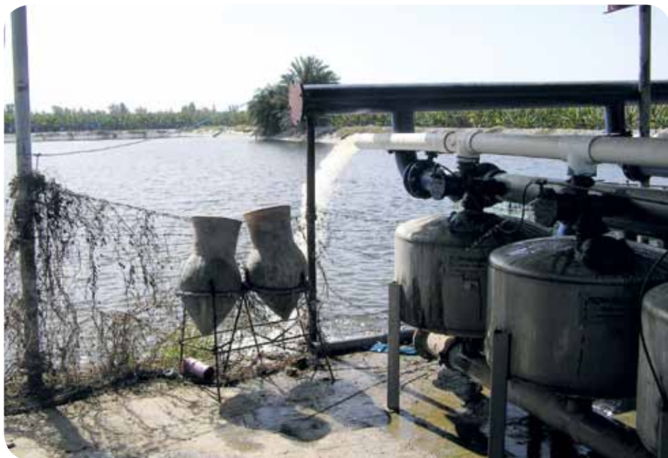
Reservoir voor opslag van irrigatiewater, met rechts de zandfilters waarmee het water gefilterd wordt voordat het voor druppelirrigatie gebruikt wordt
