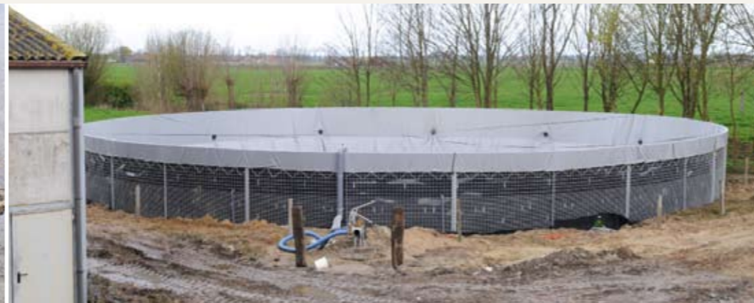
Een mestbassin voorziet in de opslag van 1500 kuub digestaat
