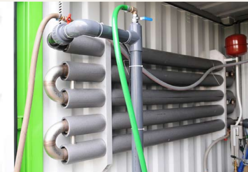
De circulatiebuizen zorgen voor warmteuitwisseling tussen mest en water
