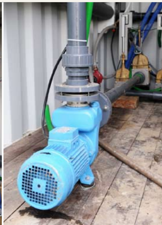
De circulatiepomp brengt mest in de warmtewisselaar
