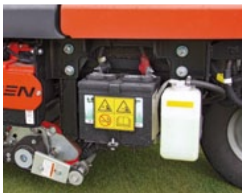
De rechteraccu start de motor, de twee links slaan reststroom op, bijvoorbeeld van remmen.
