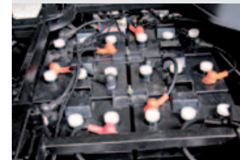
De negen onderhoudsvrije accu's van elk 8 volt bevinden zich onder de stoelzittingen.
