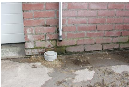
Condensafvoer aan de buitenkant van de cel
