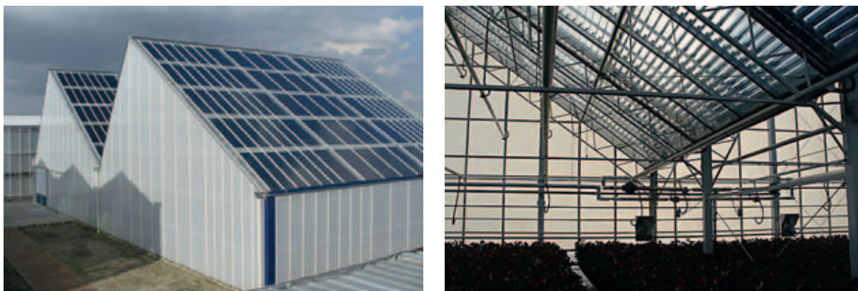
Figuur 15. ZonWindKas met beweegbare lamellen in het zuiddek die overtollig zonlicht om kunnen zetten in warmte en in principe ook in elektriciteit (foto links buitenkant, foto rechts binnenkant).
