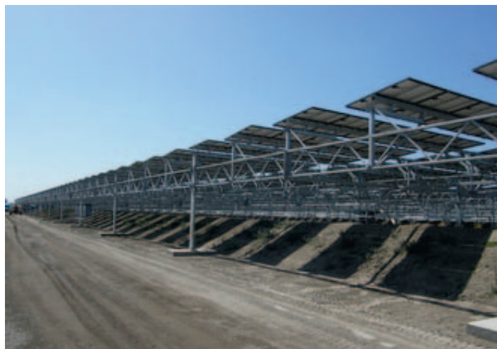
Figuur 7. Zonnepanelen boven het regenwaterbassin (Foto Kubo, Monster).
