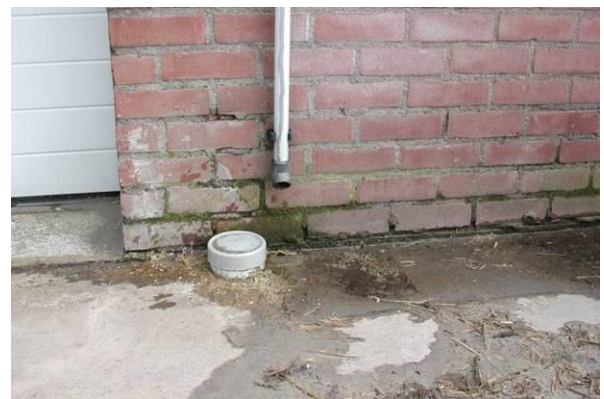
Condensafvoer aan de buitenkant van de cel (met een watervoerende sloot op korte afstand)
