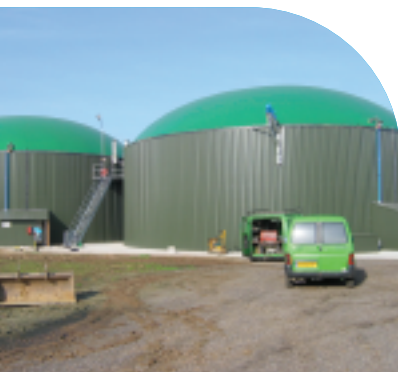
Mestvergistingsinstallatie in Wanroij
