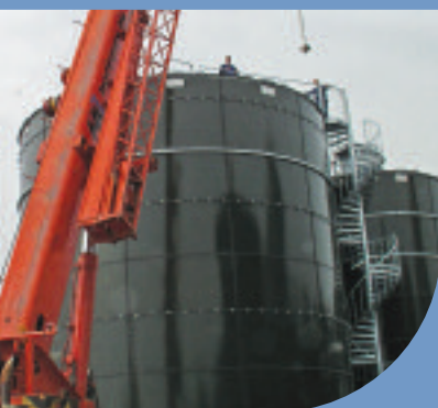
Voor het demonstratieproject is een nieuwe installatie neergezet
