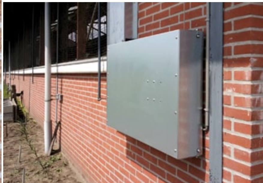
Een verzinkte kap beschermt hier de kabelwikkel.
