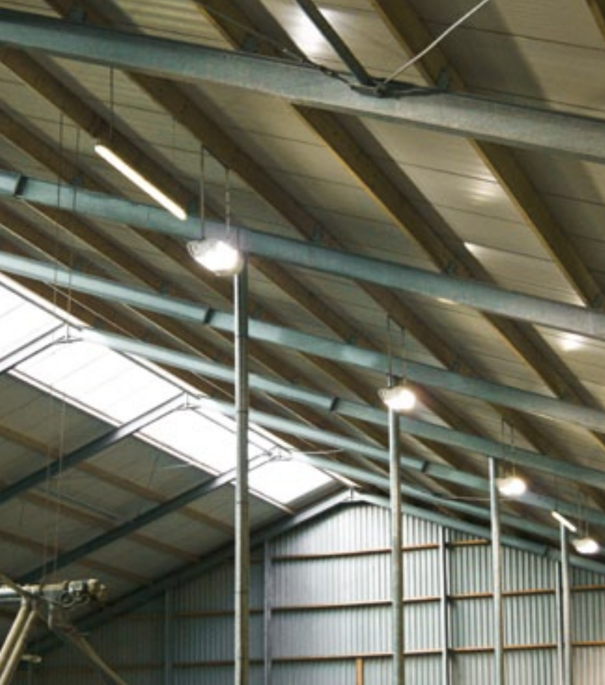
Mattheüs Gorter wisselt metaalhalidelampen af met tl-licht. De lampen hangen 4 meter boven de goot.
