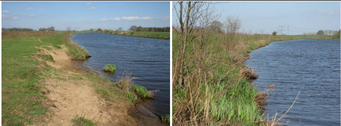
Figuur b15.3 Foto's van de ontsteende oevers benedenstrooms van stuw Vechterweerd
