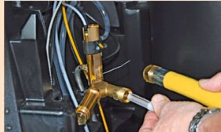
▲ Warmwaterreinigers hebben een 'watertekortbeveiliging'. Die verhindert dat de brander bij te weinig water wordt ingeschakeld. Een zeef gaat verontreiniging van de beveiliging tegen. Die zeef moet regelmatig gereinigd worden en is gemonteerd tussen de perszijde van de pomp en de warmwaterboiler.
