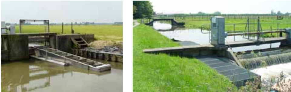
Links een foto van de 'Meyberg' vispassage in Alm en Biesbosch. Deze passage heeft als voordeel dat die aan de stuwklep kan worden gehangen en makkelijk is te verplaatsen (mobiel). De passage is ontwikkeld door Tauw (Foto: Jasper Arntz). Op de rechterfoto staat een aangepaste 'De Wit' passage die gerealiseerd is in het Kromme Rijngebied
