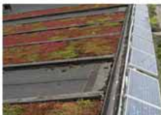
Groen dak in combinatie met zonnepanelen
