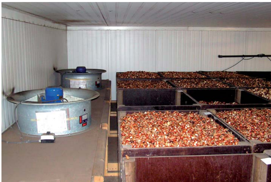
Na het drogen kan met frequentieregelaars het toerental van de ventilatoren traploos worden aangepast
