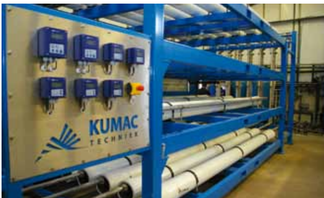
◀ Het duurde twee jaar voordat de osmose-installatie naar behoren functioneerde.
