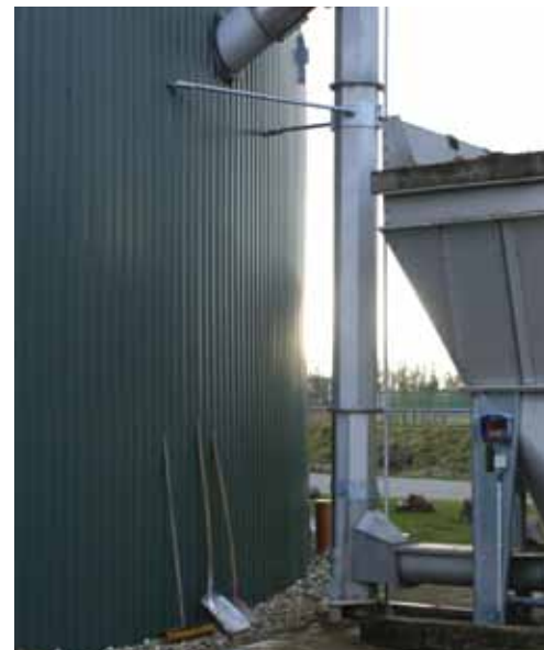
◀ Over de hele installatie is goed nagedacht. Zo is de opvoervijzel voor de bijproducten niet rond, maar achthoekig. Dit voorkomt dat het product mee gaat draaien en veel slijtage geeft. Nu wordt het echt omhoog geduwd.
