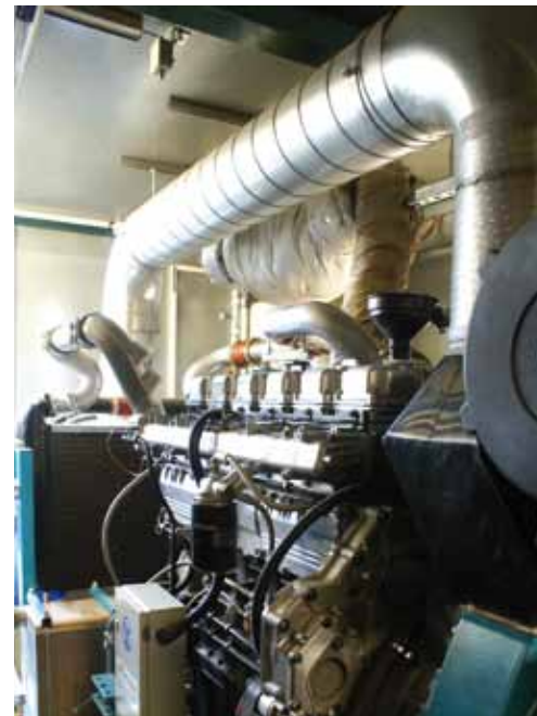
◀ De door biogas aangedreven motor levert continu tegen de 250 kW. Onder die grens is de subsidie per geproduceerde kWh het hoogst.
