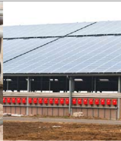
Zonnepanelen op één kant van de stal
