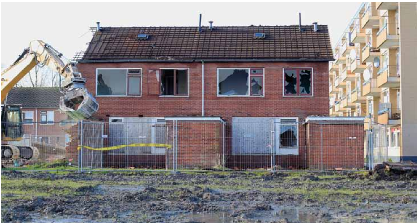
Woningen in Delfzijl worden gesloopt. In Noordoost-Groningen zijn de gevolgen van bevolgingskrimp al duidelijk zichtbaar. Demografen voorspellen ook afnemende bevolking in veel andere regio's.
