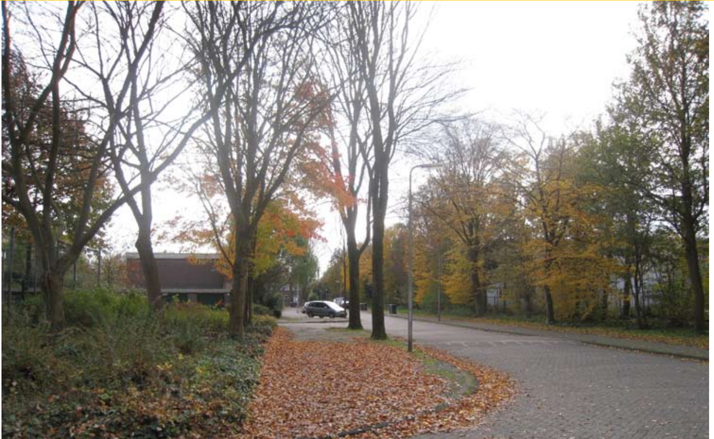
Zilveresdoorns, bekend om hun oppervlakkige beworteling, zijn zo'n 40 jaar geleden in de stoep direct langs een trottoirband aangeplant. Er is sprake van verhardingsopdruk. In de omgeving is voldoende groen aanwezig. Wortelsnoei of kap van de boom zijn hier mogelijke oplossingen volgens het model. het Deventer-protocol schrijft de oplossing voor.
