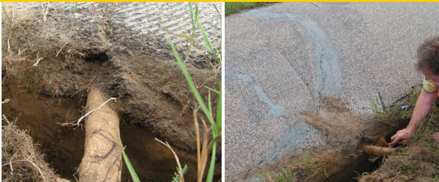
De wortelopdruk bij het asfalt fietspad, ondanks het eerder geplaatste anti-wortelscherm. De wortels groeien onder het scherm door. Bron: Alles over Groenbeheer
