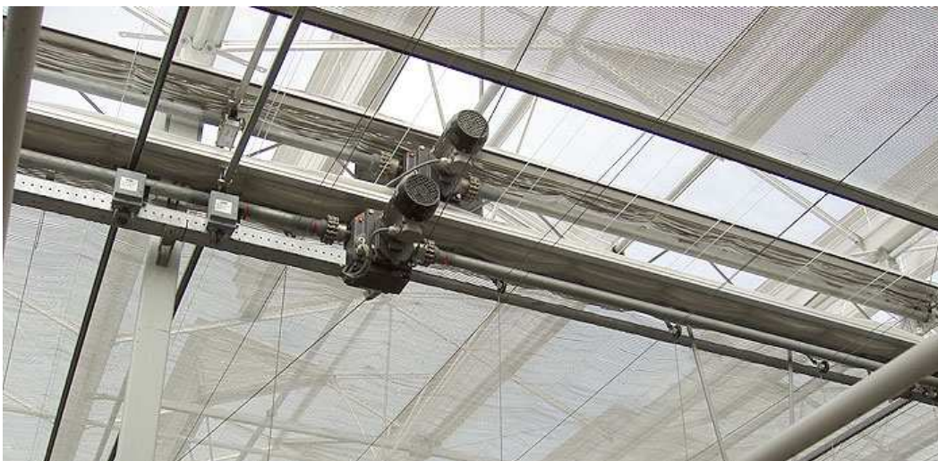
Figuur 1. Een scherminstallatie met drie schermen over twee dradenbedden
