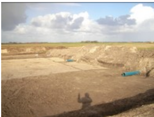
Foto 3. Diepste gedeelte van de ontgraving met de drie pijpen zichtbaar waardoor irrigatie/inundatie plaatsvindt. Ook zichtbaar de verschillen oorspronkelijk ontgravingsniveau (midden) en teruggebrachte humeuze bovengrond (voor en achter).
