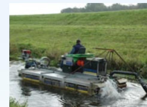
De bagger wordt via een vaartuig met schoepen uit de watergang gezogen en via een lange slang naar de wal geperst.
