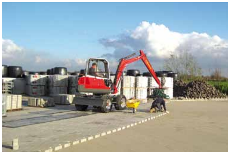
◀ Een goed onderbed, strak werk en volgens een doordacht plan de zaak machinaal bestraten, zijn de hoofdingrediënten. Dat stelt hoge eisen aan de medewerkers.
