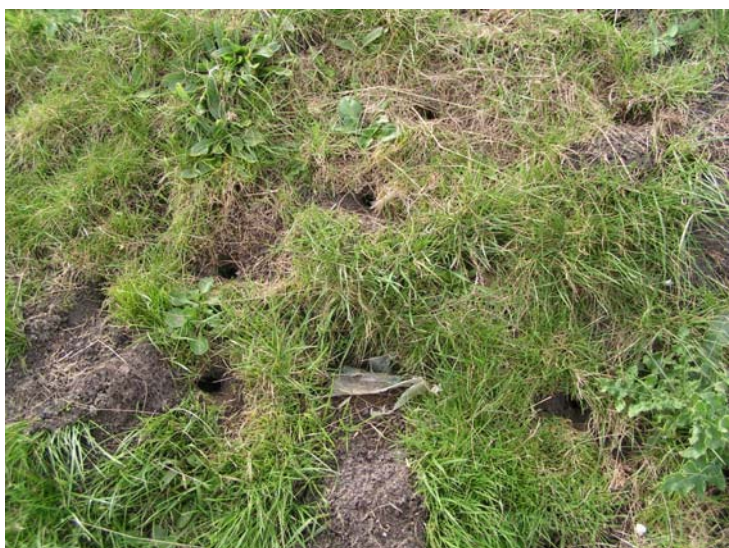
Hondsbossche Zeewering (2004); onbegraasd buitentalud met massaal voorkomende muizenholen.
