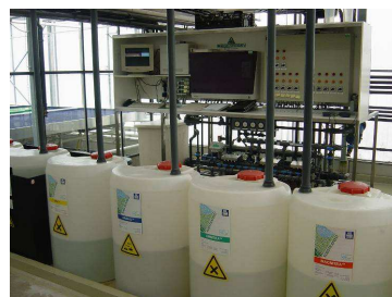
Voeding afstemmen op maximaal drainwaterhergebruik
