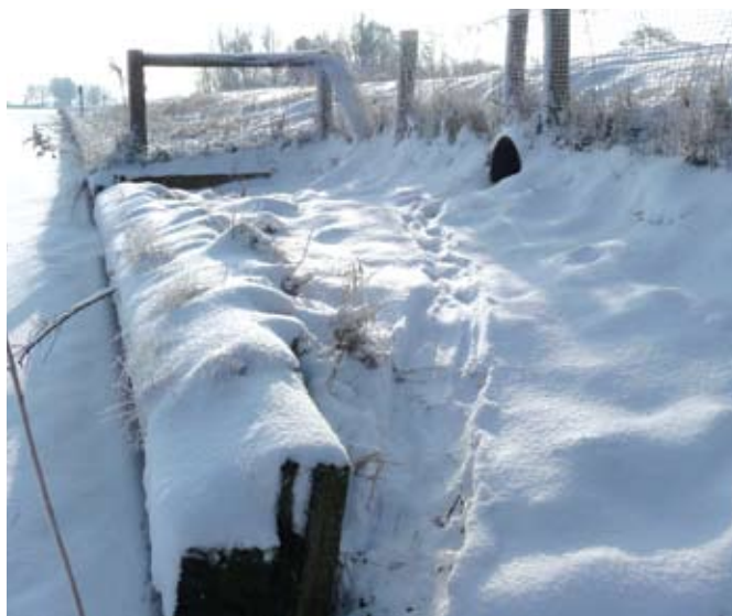
Ottertunnel, een droge duiker onder de weg door in combinatie met geleideraster. Deze maatregel wordt vooral toegepast bij een drukke weg die een moerasgebied doorsnijdt.
