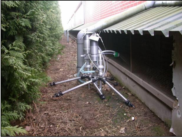
Luchtinlaat buitenzijde in de zijgevels
