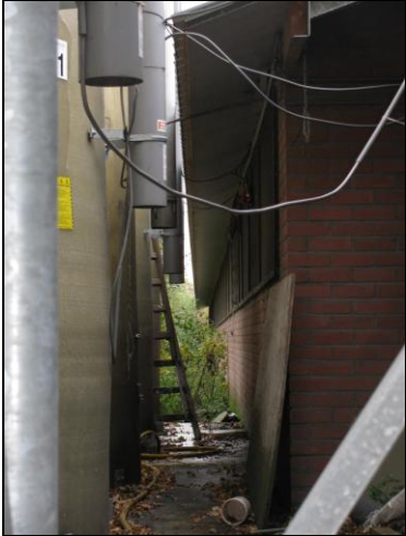
Luchtinlaat buitenzijde in de zijgevels
