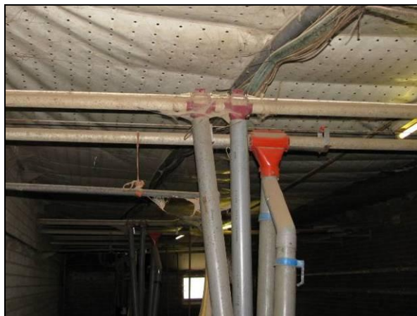
Luchtinlaat afdeling (plafondventilatie)
