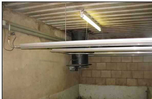
Luchtinlaat afdeling (plafondventilatie)
