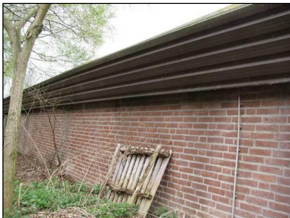
Luchtinlaat buitenzijde in de zijgevels
