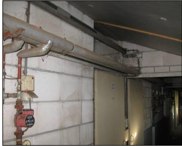
Luchtinlaat afdeling (opening boven de deur)
