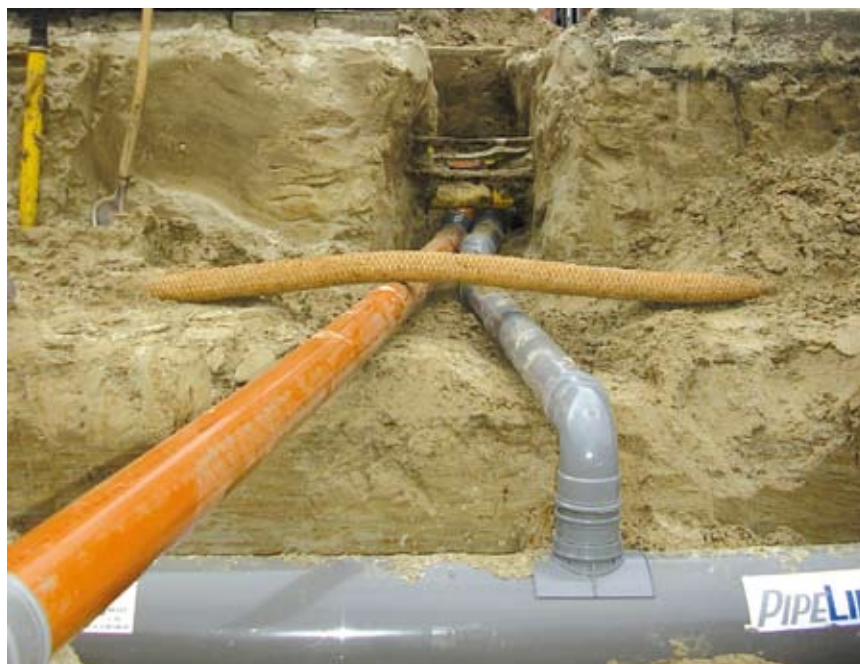
De kabel- of leiding beheerder geeft alleen informatie over de horizontale ligging.
