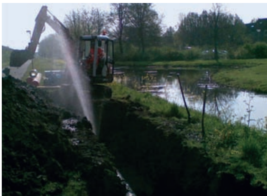
'Onbegrepen' lekkage in een PVC-leiding.
