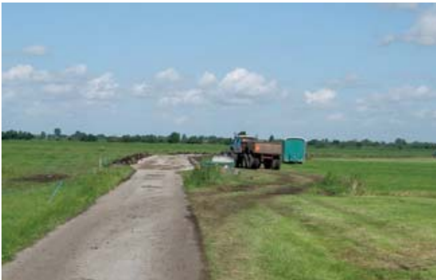
Maar liefst 300 meter kavelpad werd overlaagd. In totaal heeft het pad een lengte van 600 meter
