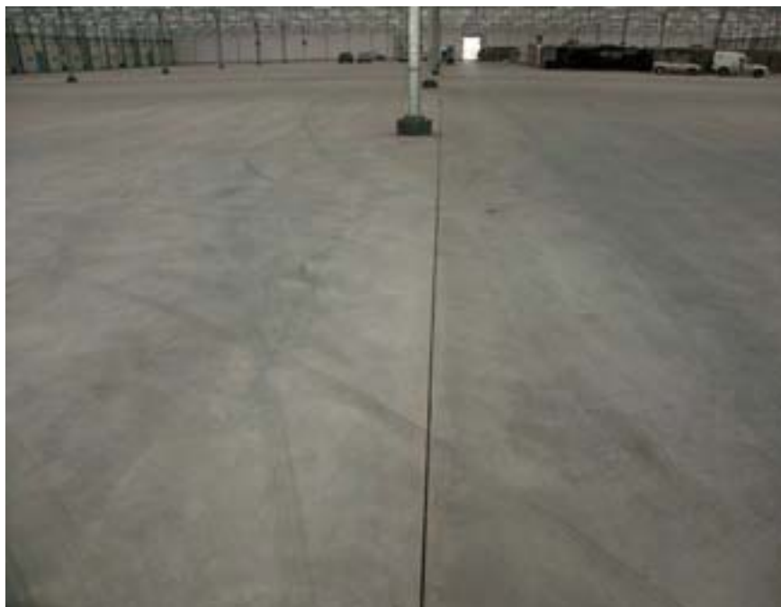
Studiecel 9 heeft een rapport geschreven over de beheersing van scheurvorming
