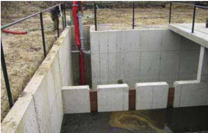
Bezinkput met verschillende compartimenten waar het zand zakt op de bodem. Over de put ligt een dek van beton waar een kraan het zand uit de put schept
