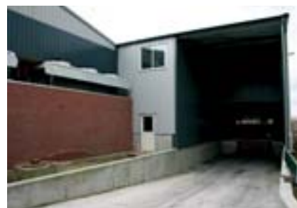
De nieuwe ter plaatse gestorte laadkuil van 25 m lengte ligt bij de verwerkingsruimte
