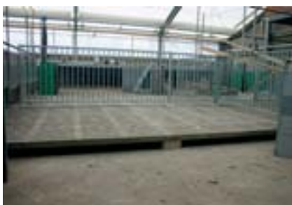
In het mestgedeelte ligt een betonrooster, dat enkele centimeters boven het middengedeelte uitsteekt
