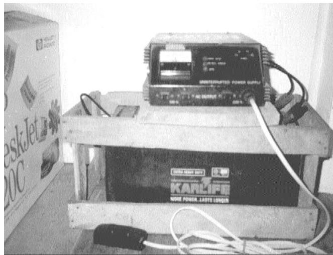
Fig. 4.5 12Volt DC – 220Volt AC power inverter
