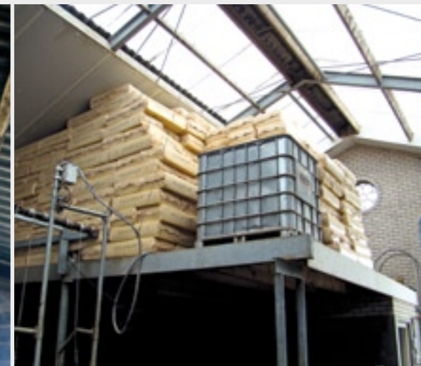
Door het voorraadvat hoog te plaatsen, vult het systeem zich automatisch.
