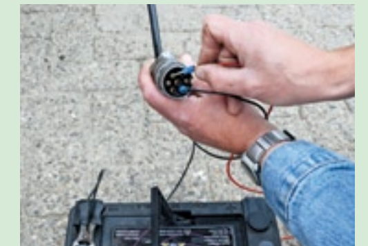
▲ Voor een controle van de stekker en de bedrading kun je een accu gebruiken. Door de massa aan te sluiten op de massa van de stekker, is met de plusdraad iedere draad en lamp te controleren. Let hierbij wel op dat je geen kortsluiting maakt. Ook kun je controleren of het universele aansluitschema van de stekker is gebruikt. Het gebruik van het universele aansluitschema vergroot de mogelijkheid om wagens achter verschillende trekkers te gebruiken.
