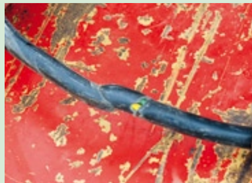
▲ Het onderhoud van verlichting begint bij de controle van de kabel tussen het trekkende voertuig en de aanhangwagen. Bij het aansluiten van de aanhangwagen is het heel belangrijk dat je let op de plaats van de kabel. Zorg ervoor dat deze nergens tussen kan klemmen. Maar ook de lengte is heel belangrijk. Vervang beschadigde kabels zo spoedig mogelijk.
