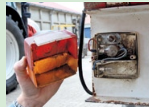
▲ Een andere bron waardoor problemen met verlichting kunnen ontstaan, is het ontbreken of het beschadigen van de buitenisolatie. Bij de stekkers moet je de buitenisolatie onder een klem monteren. Maar ook bij de aansluiting met de lampen mag je de buitenisolatie niet te veel weghalen. Te veel weghalen vergroot de kans op storingen. De lamp is meestal voorzien van een doorvoer met rubberen afsluiting. Deze is berekend op een kabeldikte met buitenisolatie.
