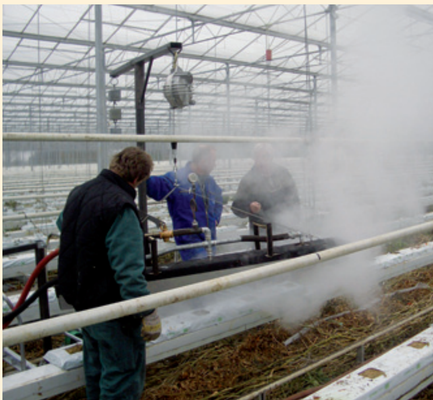
Ontsmetten van éénjarige matten op de goot, hier bij Van der Lans in Maasland. Onderzoek wijst uit dat het stoominjecteren de aanwezige schimmels en bacteriën volledig doodt.
