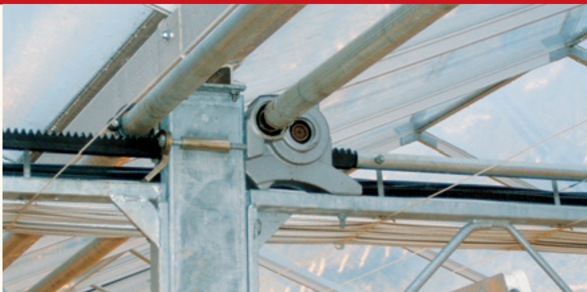
Aandrijfassen van dunwandige 5/4" buizen kunnen bij een hoge belasting blijvend vervormen.
