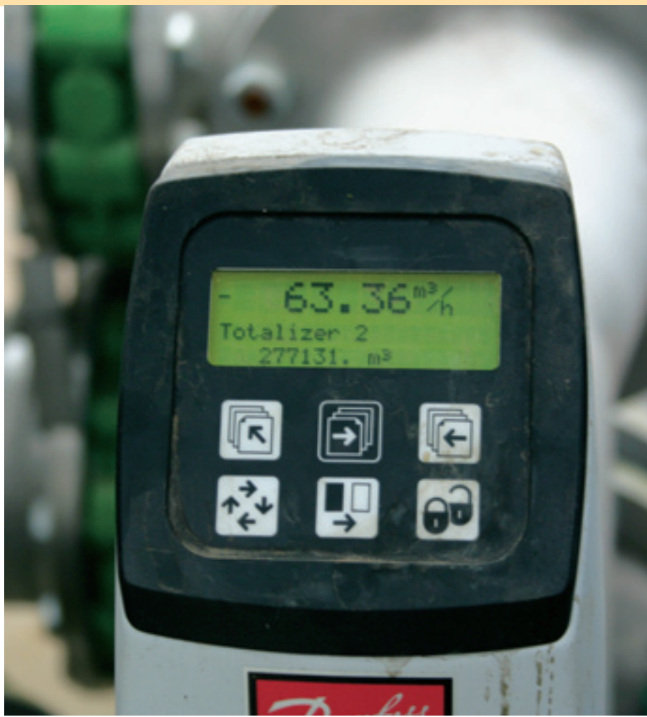
Dit apparaat geeft aan hoeveel grondwater uit de warme bron wordt onttrokken: 63,36 m 3 op het moment van fotograferen, vanaf installatie al 277.131 m 3 .
