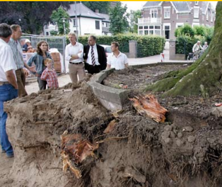
Graafwerkers hebben de voorheen kerngezonde wortels van de plataan met een graafmachine compleet afgerukt. Die kunnen niet langer voor stabiliteit of grondwater toevoeren zorgen. Op de achtergrond in pak wethouder Van Swam. Foto: Jan Rikken
