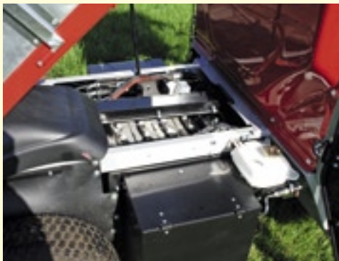
Het accupakket bevat 24 stuks van 2 volt. Het witte tankje is om de accu's bij te vullen.
