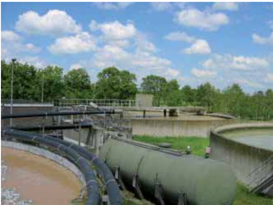
Awzi Marum met op de voorgrond de voordennitrificatiereactor.
